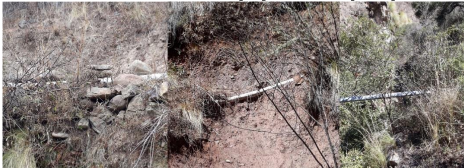
Gráfica 4. Punto del sistema tuberías propensos a romperse por derrumbes
