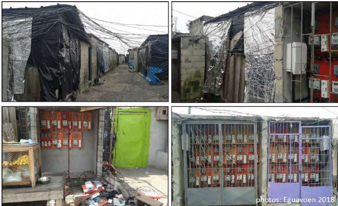
Image 20 Installation électrique (les niches d'électricité) et compteurs
