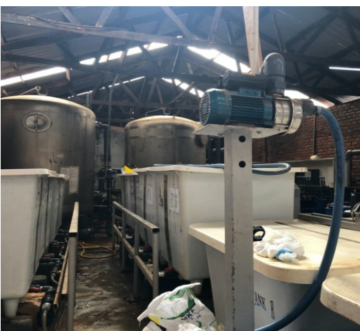
Abb. 4: Wasserpumpe zur Filterung des Seewassers (KUNSCHKE 2020)
