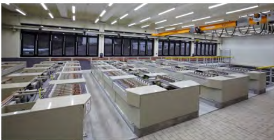
Bild 1: Elektrolysezellen im Refining
